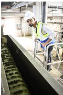
Vérification de l'épaisseur à bande gravitaire
