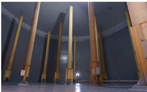
Pompes Geyser à l'intérieur de Digelis®
