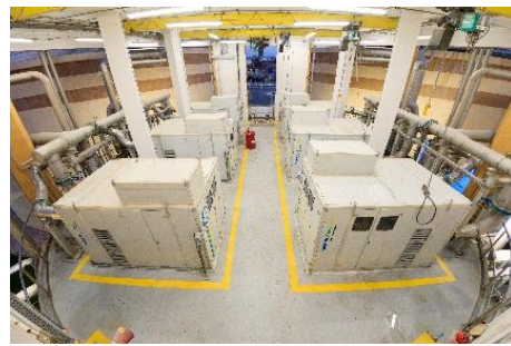
Salle de compression du biogaz (1 361 m³/h)
