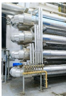
Recirculation et chauffage des boues de digestion
